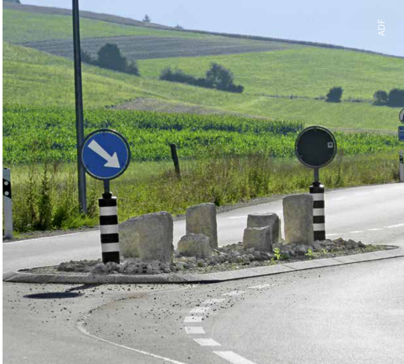
Kieselsteine werden in die Fahrbahn getragen und bergen ein Sicherheitsrisiko, insbesondere für Motorradfahrer.
